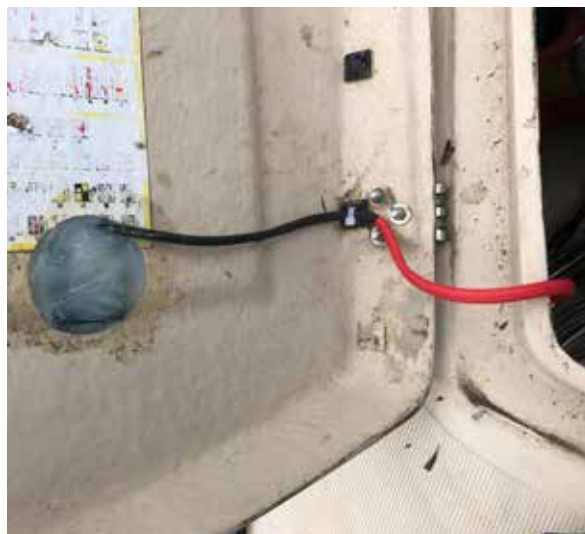
Bild 2. Undersidan av luckan. Det stora hålet är från en tidigare solcell som fick kortslutning efter sju års användning. Den hade en kontakt som gjorde hålet nödvändigt. Kom ihåg att förstärka och skydda sladden ordentligt med till exempel krympslang så den inte nöts när luckan rör sig.
