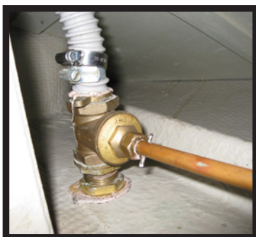
Avstängningsventil med påmonterad fjärrmanövrering.
